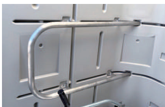
U 字型手すり
